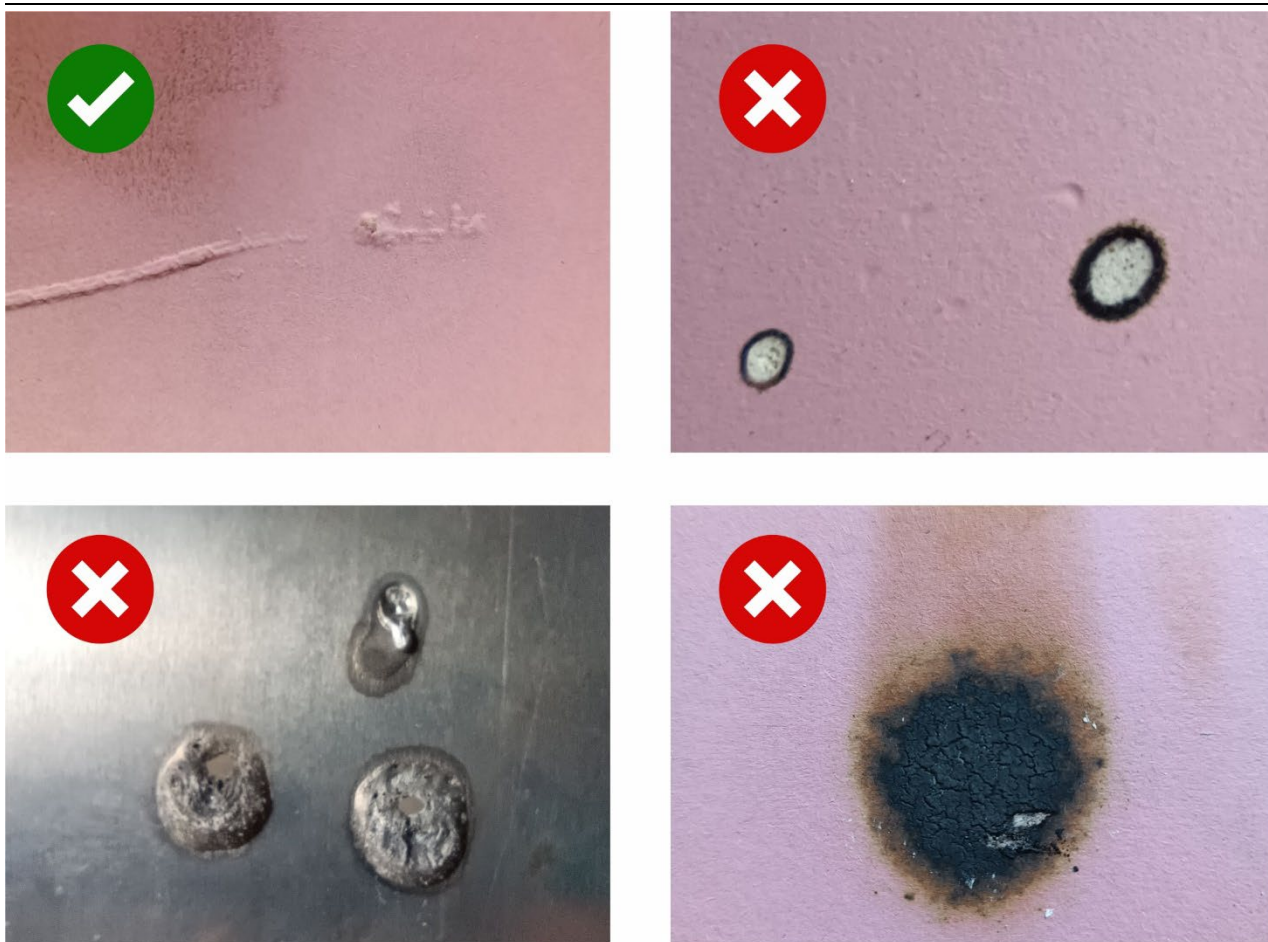
Figura 5.2 Esempi di danni alla barriera
